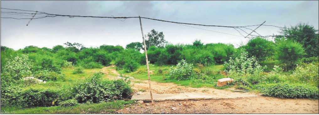
बांस-बल्ली के सहारे टिकी एलटी लाइन।
